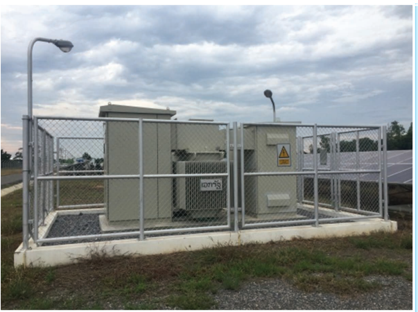
หม้อแปลงไฟฟ้า (Transformer)
