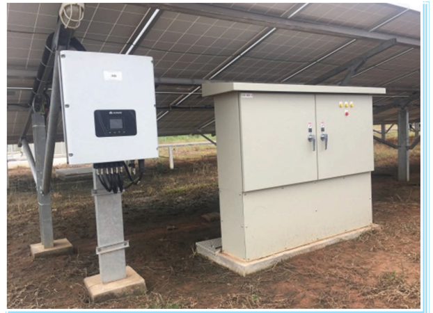
เครื่องแปลงกระแสไฟฟ้า (Inverter) / DC Combiner Box
